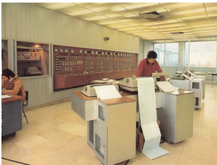
La sala de comandament de Vandellòs I. FONS HIFRENSA
